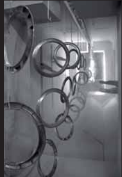
Installation automatique de tunnel de prétraitement de dégraissage et pour déphosphater, cabine de peinture en poudre automatique et four de polymérisation.
