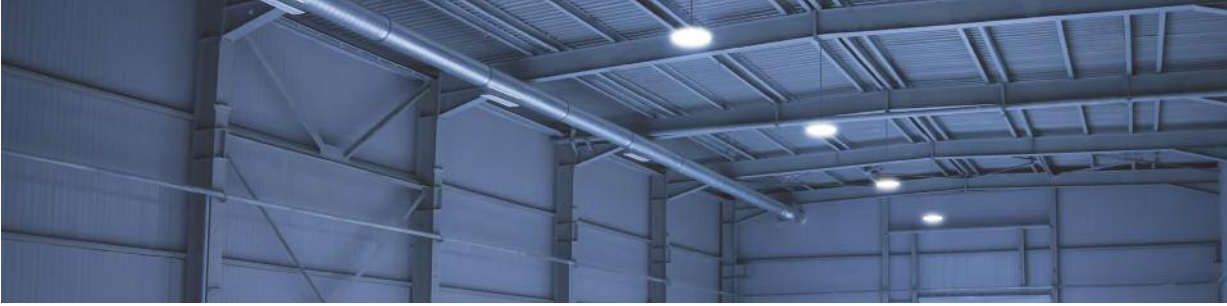
Iluminación industrial Industrial lighting
