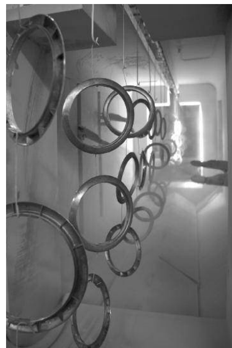
Instalación automática de túnel de pretratamiento de desengrasado y desfosfato, cabina de pintura en polvo automática y horno de polimerizado.
