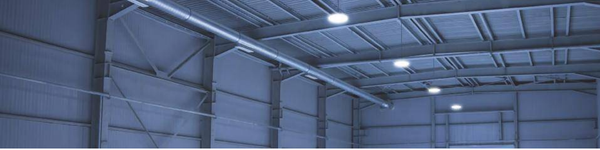
Iluminación industrial Industrial lighting
