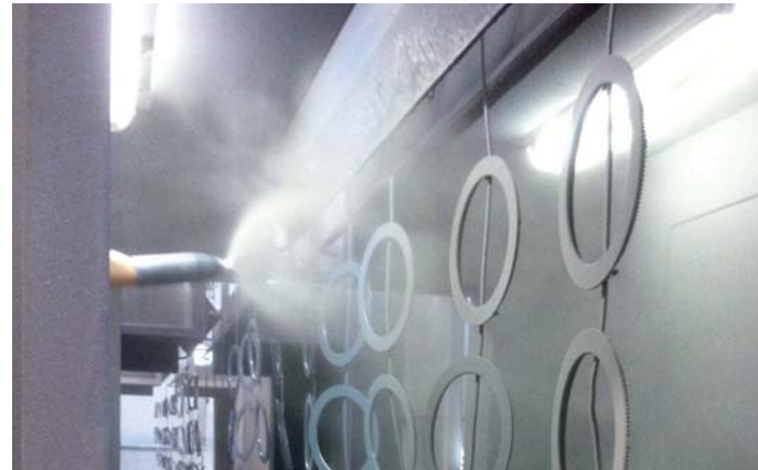
Instalación automática de túnel de pretratamiento de desengrasado y desfosfado, cabina de pintura en polvo automática y horno de polimerizado. Automatic installation of tunnel for defosfating and degreasing, powder coating booth and polymerization oven.
