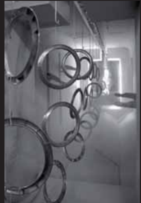
Instalación automática de túnel de pretratamiento de desengrasado y desfosfato, cabina de pintura en polvo automática y horno de polimerizado.
