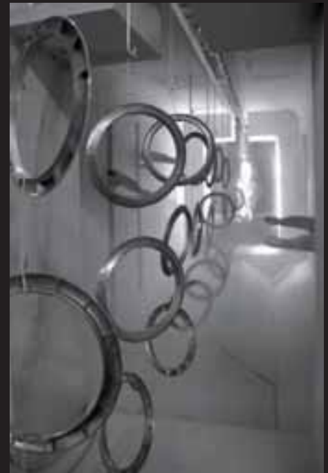
Installation automatique de tunnel de prétraitement de dégraissage et pour déphosphater, cabine de peinture en poudre automatique et four de polymérisation.
