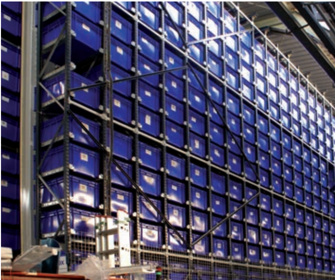
Sistema de almacén y dispensación robotizada de productos Robotized warehousing system.
