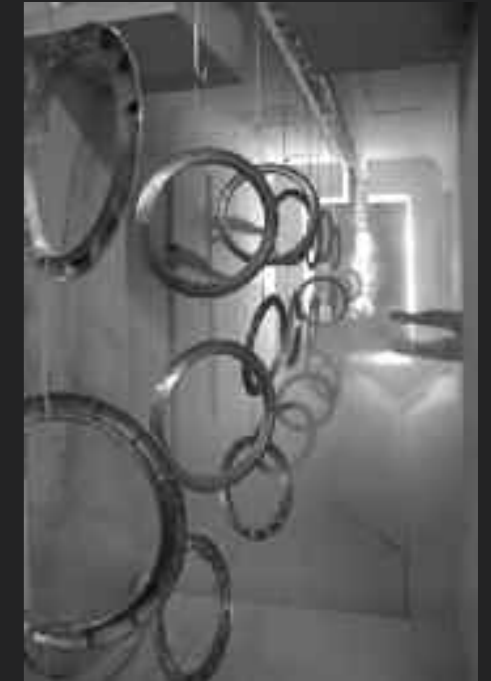
Instalación automática de túnel de pretratamiento de desengrasado y desfosfatado, cabina de pintura en polvo automática y horno de polimerizado.
