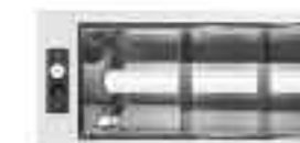
Control de flujo luminoso y presencia
