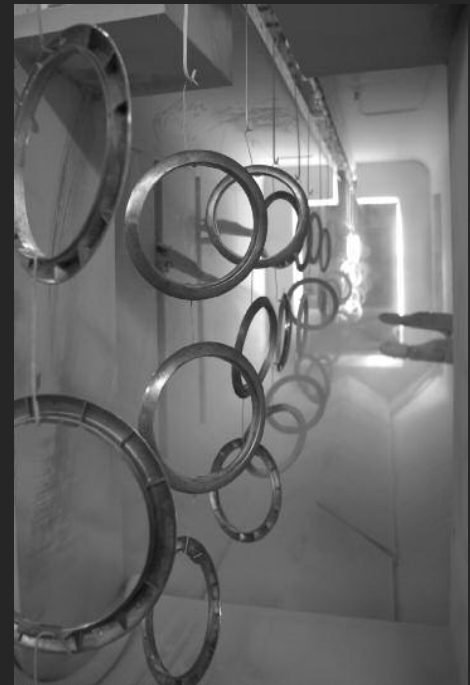
Instalación automática de túnel de pretratamiento de desengrasado y desfosfado, cabina de pintura en polvo automática y horno de polimerizado.
