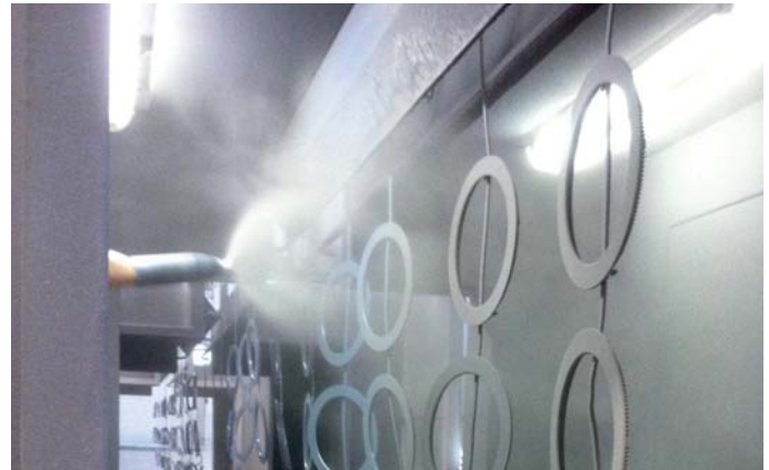
Instalación automática de túnel de pretratamiento de desengrasado y desfosfado, cabina de pintura en polvo automática y horno de polimerizado. Automatic installation of tunnel for defosfating and degreasing, powder coating booth and polymerization oven.
