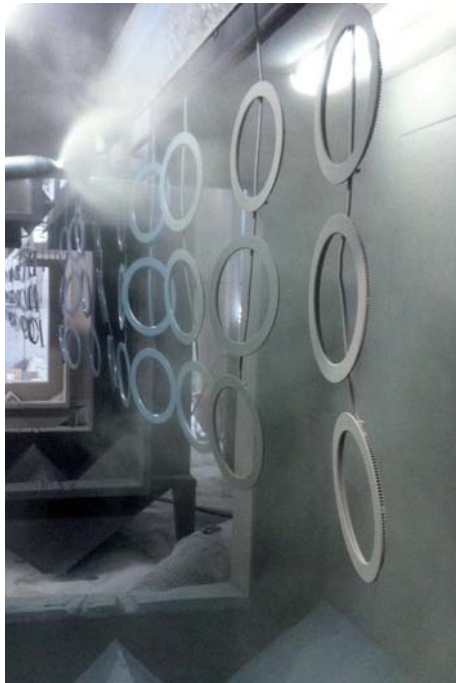
Instalación automática de túnel de pretratamiento de desengrasado y desfosfatado, cabina de pintura en polvo automática y horno de polimerizado.
