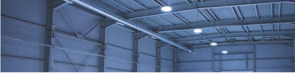
Iluminación industrial Industrial lighting
